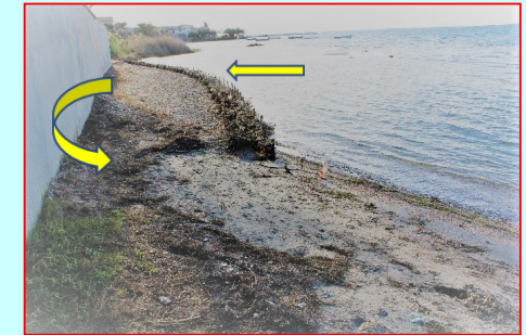
Lessivage de la berge après la montée des eaux
